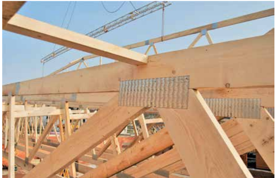
Holzkonstruktionen in Nagelplattenbauweise sollten nach Ansicht der Fachkommission Bautechnik der Bauministerkonferenz dringend überprüft werden.
